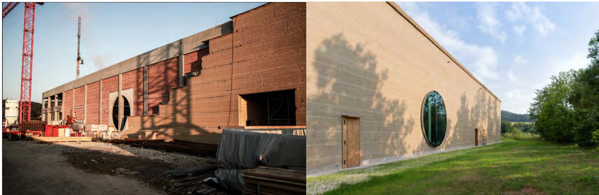
Habillage de la structure poteaux-poutres en béton avec du pisé préfabriqués © Daniel Lüthi
